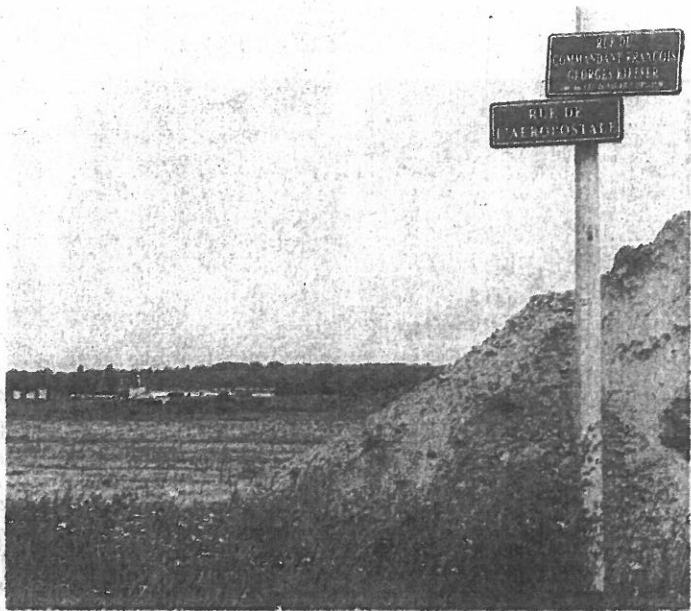
Au sud du terrain, les travaux ont commencé pour l'installation des mobil-homes provisoires. (Photo DNA - Alain Destouches)
